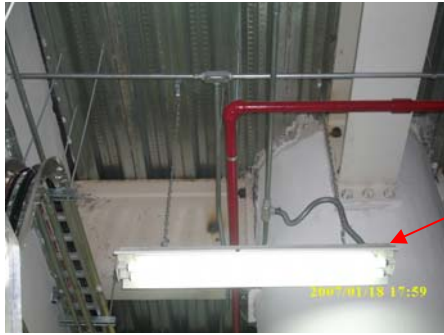
(4) Lampara fluorescente de 2x75 wats con gabinete
