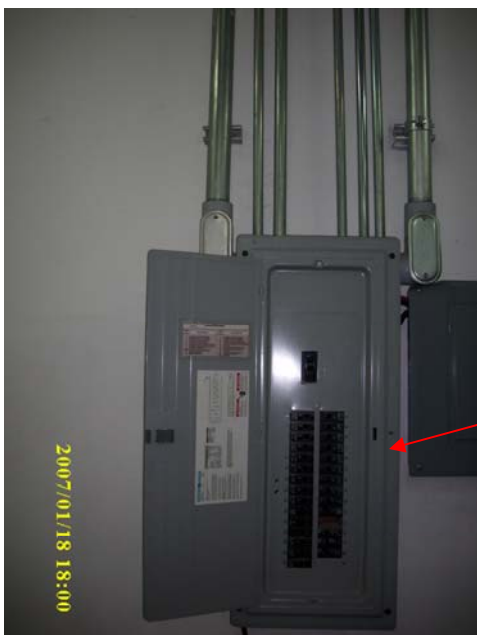
Centro de carga Q de 30 interruptores termicos
