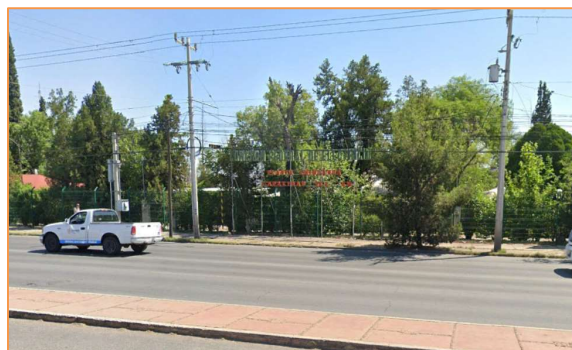
Imagen 22. Subestación Colonia Satélite. Líneas de transmisión eléctrica de alta y media tensión. Fotografía Propia.
