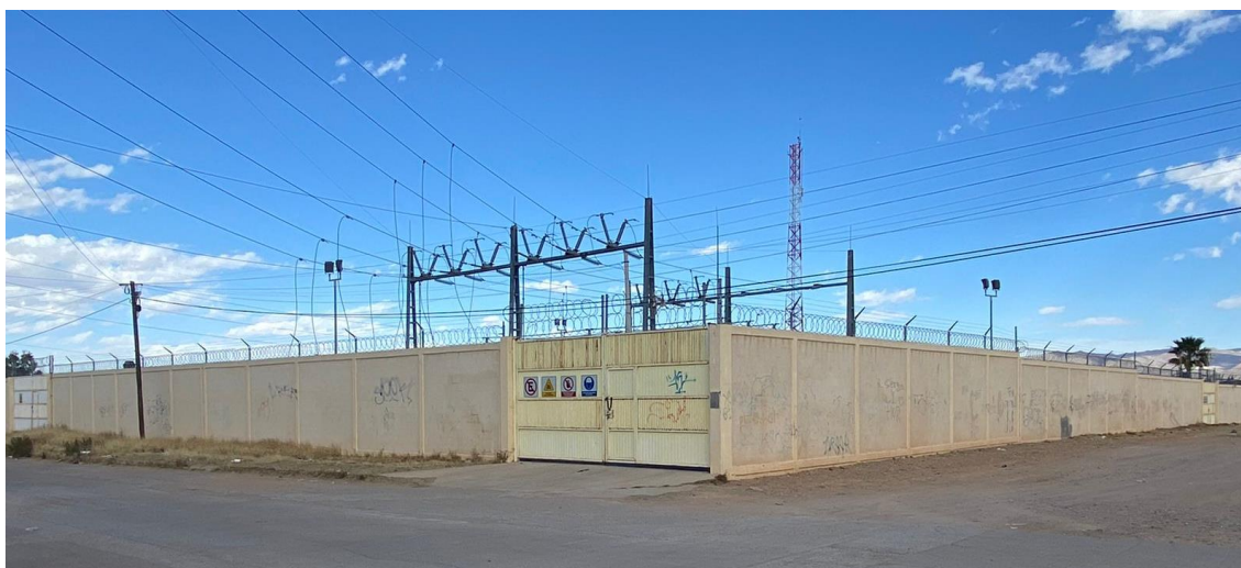
Imagen 38. Subestación de la CFE ubicada en la calle Agustín Melgar esquina con calle 17ª.
