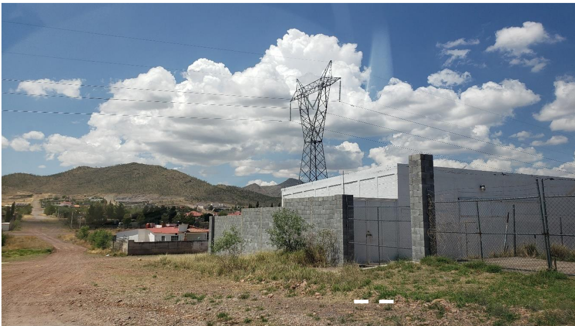
Figura 29. Infraestructura existente (eléctrico) dentro del área de estudio. Elaboración propia
