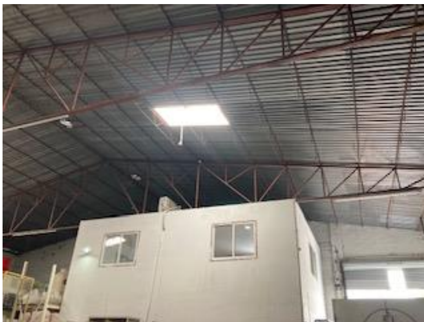
Interior de la bodega de Almacenamiento y distribución de mobiliario y equipo para renta a eventos Oficinas administrativas Fuente propia
