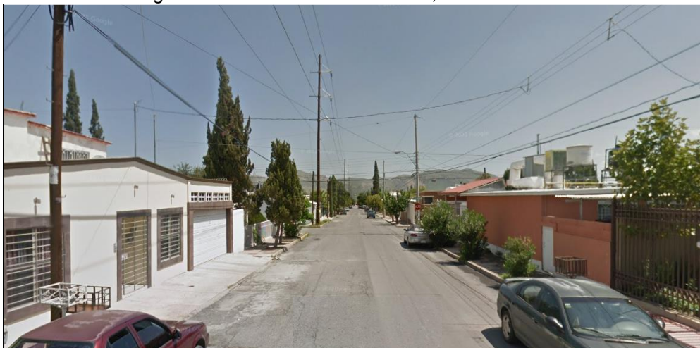
Imagen 60. Red eléctrica de 115 Kva, en la calle Cedro.
