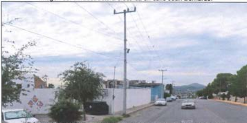
Imagen 53. Infraestructura eléctrica en calle Juan Bernardo.
