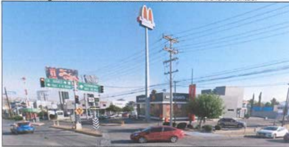
Imagen 51. Red eléctrica de 115 Kva, en el Perif. De la Juventud.
