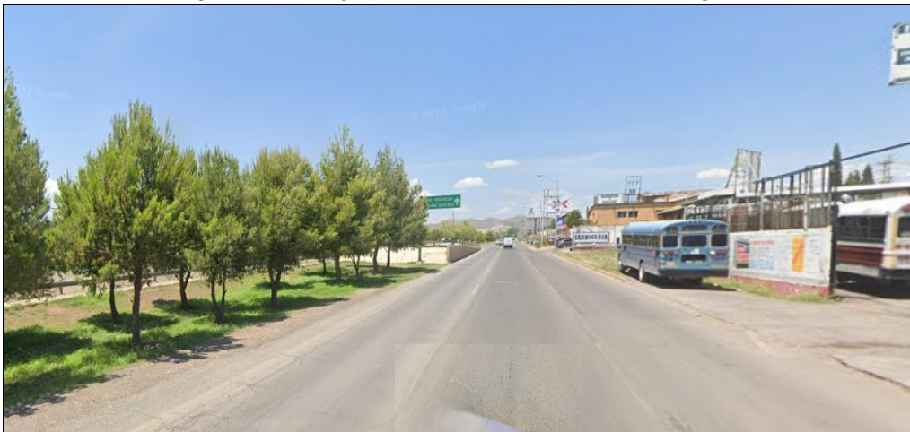
Imagen 9. Desalojo pluvial sobre la Vialidad Los nogales.
