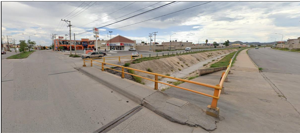
Imagen 8. Desalojo pluvial sobre la av. Los Arcos norte, al arroyo Los arcos.
