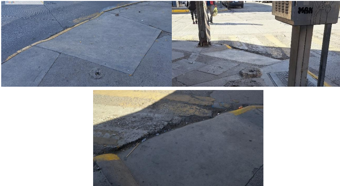
Ilustración 51. Estado de rampas en intersecciones
