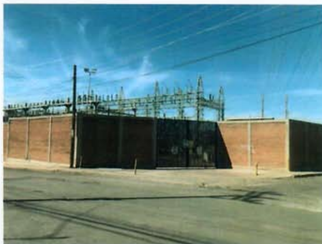
Fig. 83 Subestación eléctrica Américas. 93
