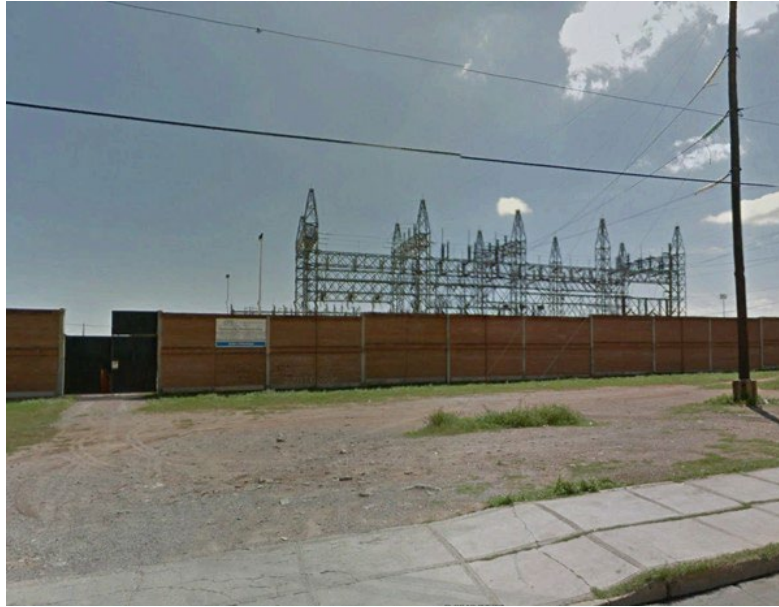
IMAGEN 56.- SUBESTACIÓN CFE. FUENTE: ELABORACIÓN PROPIA.
