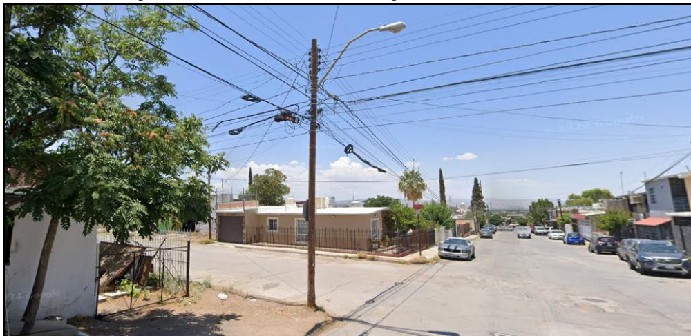
Imagen 55. Infraestructura de energía eléctrica en calle 39ª.
