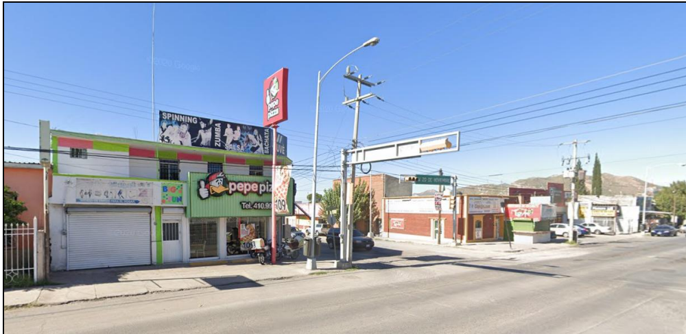
Imagen 54. Infraestructura de energía eléctrica en la Av. 20 de noviembre.
