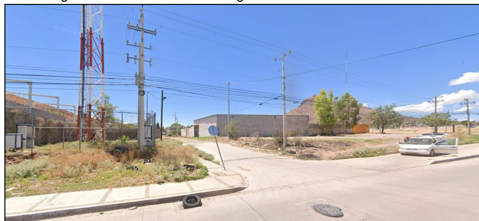
Imagen 49. Infraestructura de energía eléctrica en calle América Latina.
