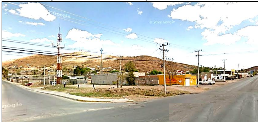
Imagen 48. Infraestructura de energía eléctrica en calle 20a.
