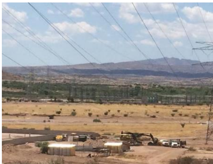
Figura 72 – Subestación eléctrica División del Norte. Fuente: Propia.
