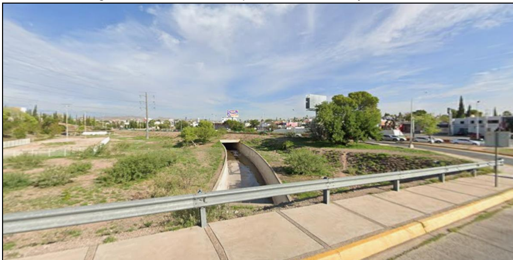
Imagen 73. Escurrimientos pluviales en el arroyo La cantera.
