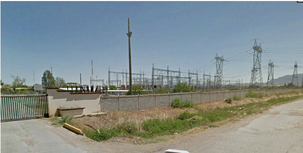
IMAGEN 153.- Subestación Avalos. Fuente: Elaboración propia.
